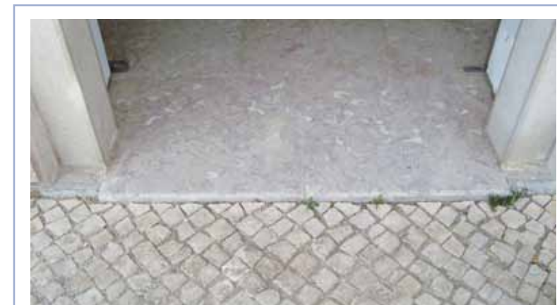
Figura 90: Soleira não regulamentar.
