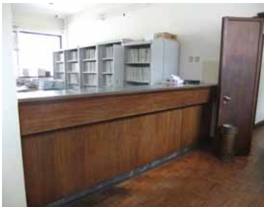
Figura 111: Balcão não regulamentar.
