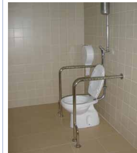
Figura 113: Instalações sanitárias não regulamentares.
