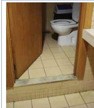
Figura105: Soleira não regulamentar.
